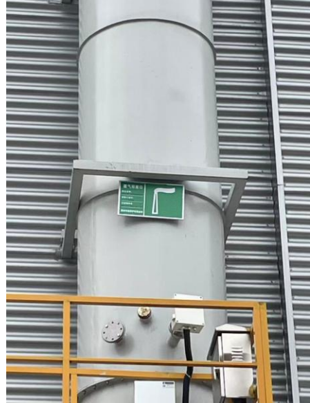
DA002 排气筒环保标识牌
