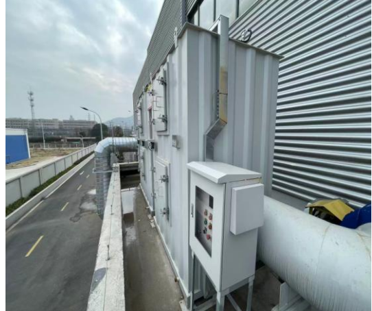
危险废物暂存库两级活性炭装置
