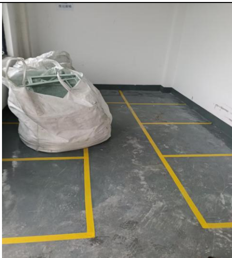
危废库地面分区
