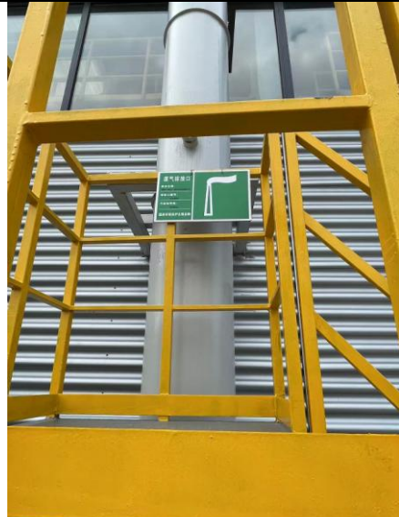
DA003 排气筒环保标识牌
