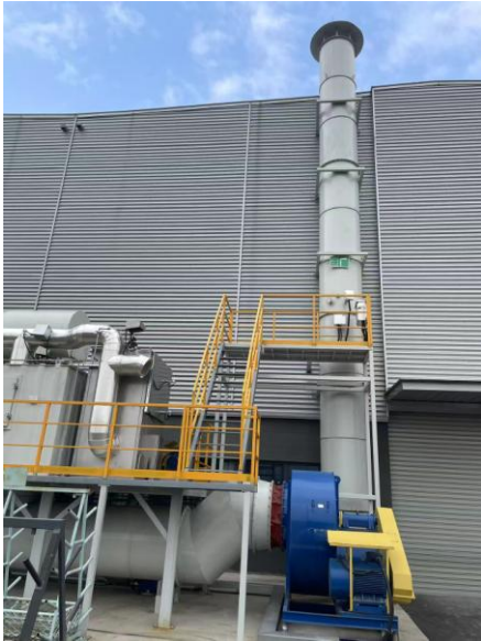
DA002 废气排气筒
