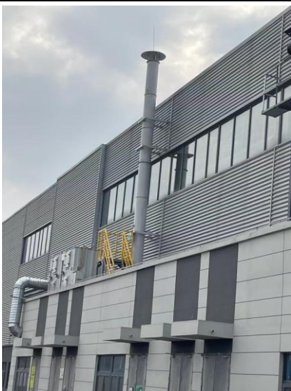
DA003 废气排气筒
