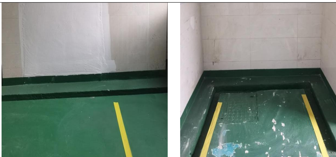
图 3-4 环氧树脂地面、分区线及导流沟
