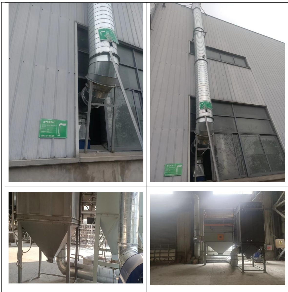
图 3-2 废气处理装置照片
