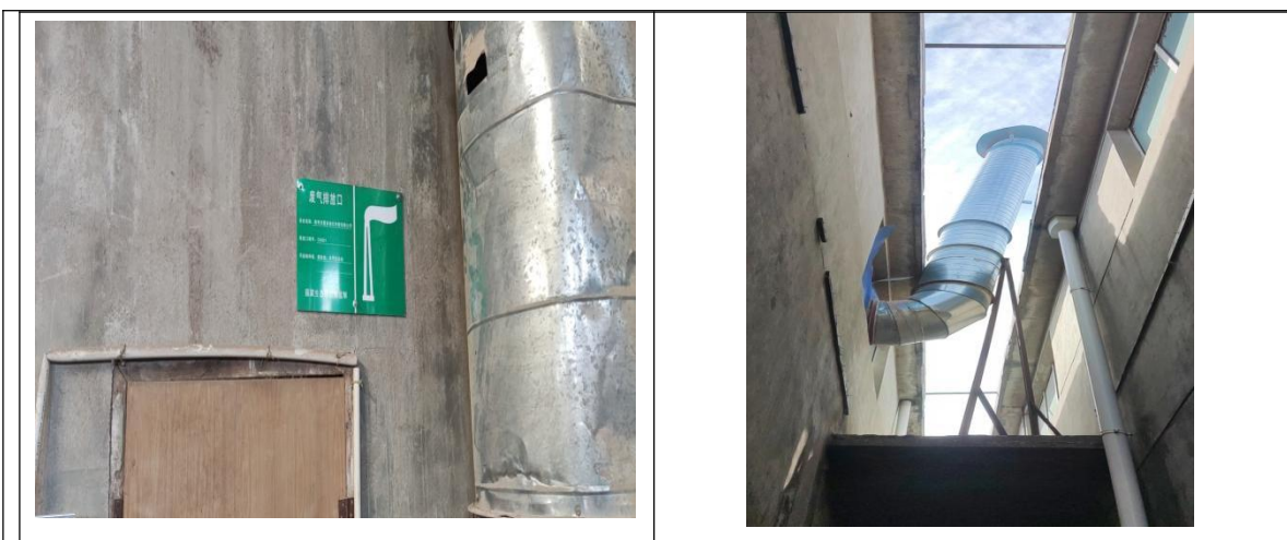
图 3-2 废气治理设施现场照片
