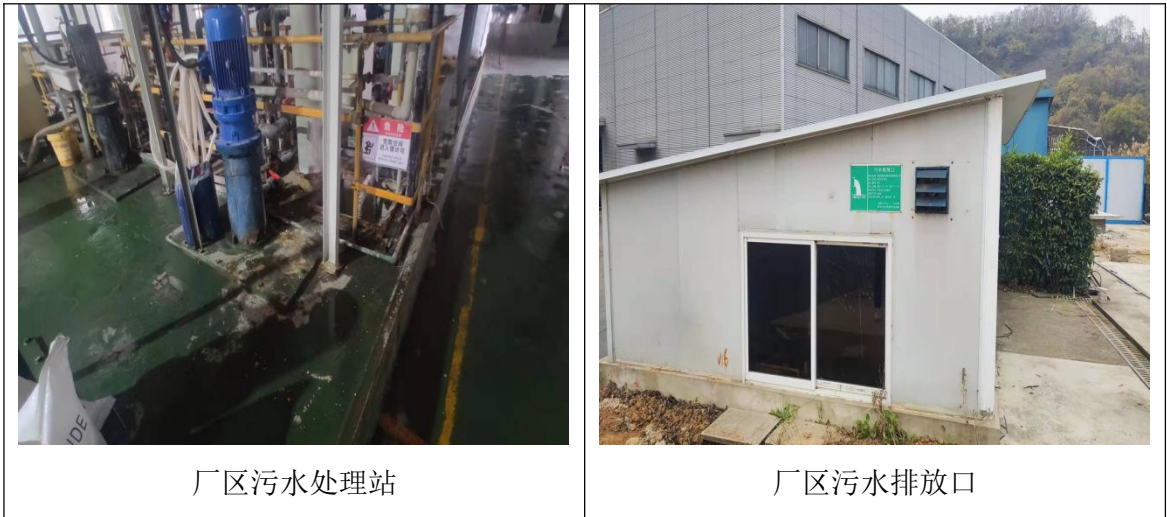
图 3-3 厂区废水处理站及污水排放口现场照片
